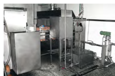
Flüssigraucheinheit zum Duschen mit Umlauf- und Speichertank sowie Rotationsfilter und Pumpen.
