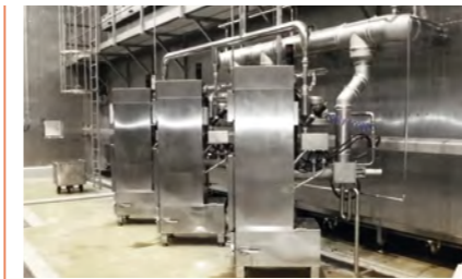
Naturraucherzeuger mit Hackschnitzeln, die flexibel je nach gewünschtem Rauchgeschmack zugeschaltet werden können.
